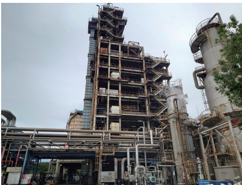
写真3：加圧二段式ガス化炉。中央の建物の中に低温ガス化炉と高温ガス化炉がある。
